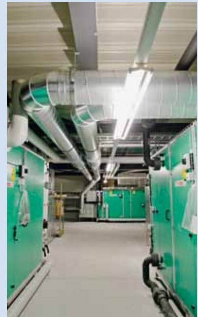
Wärmerückgewinnungsanlage – Verzicht auf Einsatz von fossilen Brennstoffen, kein CO 2 -Ausstoss mehr. (Heizöl Verbrauch in alter Anlage: 200'000 l/Jahr, 530 to CO 2 -Ausstoss) Foto: Stefan Kubli
